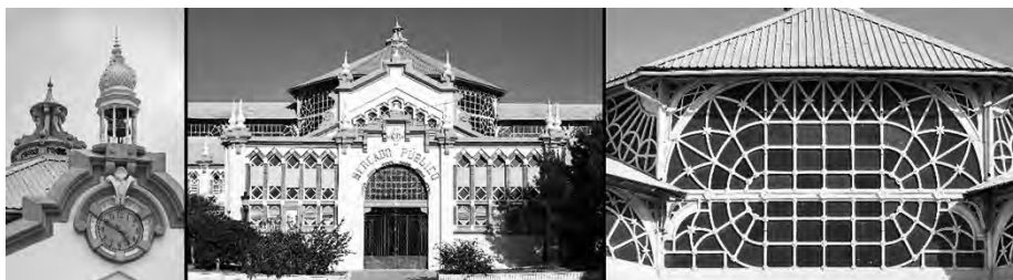
Figura 19. Vistas de elementos exteriores del edificio. Elementos de zinc en fachada principal y techo cúpula central, fachada trasera, y vidrieras del tambor de la cúpula central.
